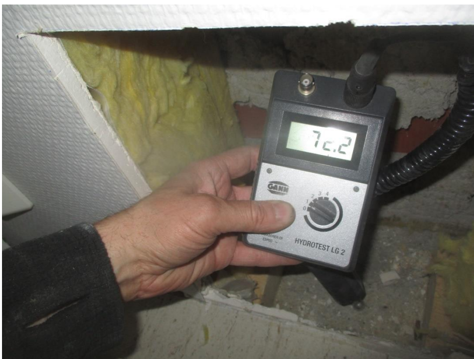
Bild 24: Håltagning i yttervägg, fuktmätning på sockel
