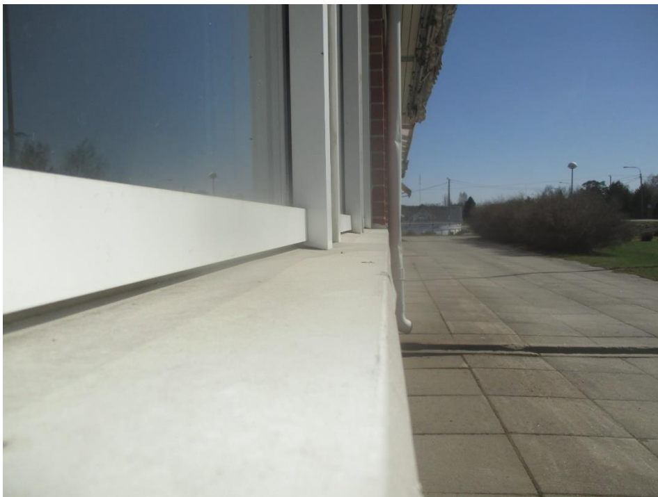
Bild 14: Bristfällig lutning på fönsterplåt
