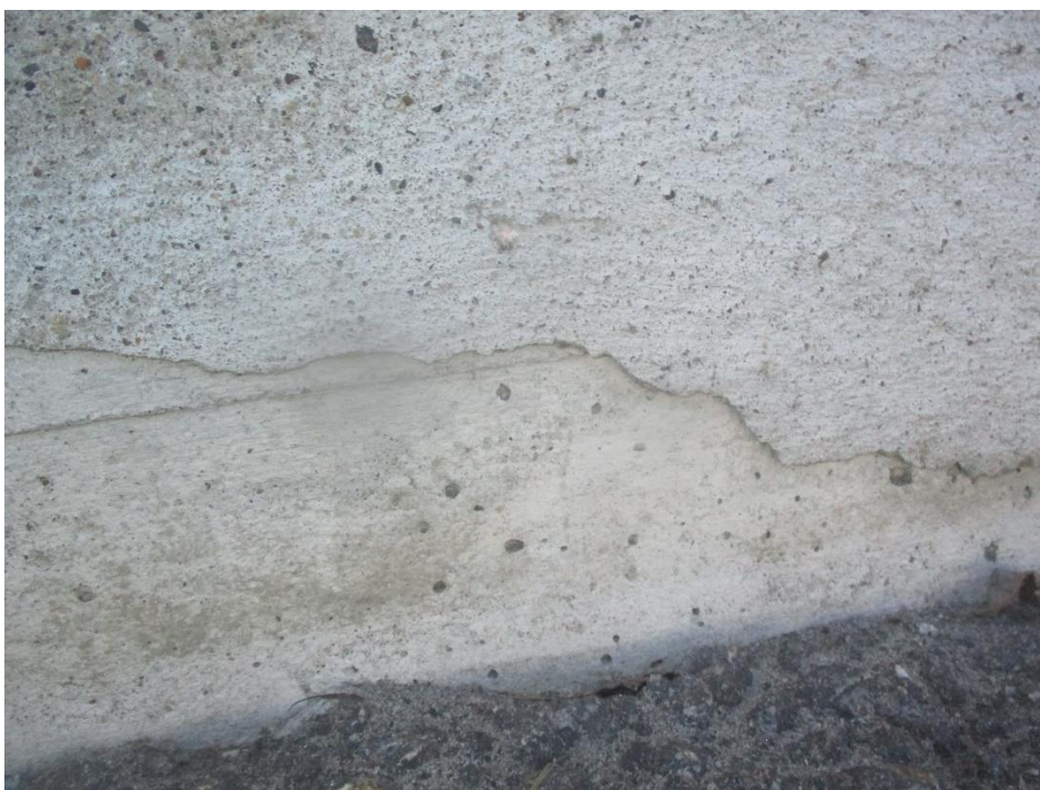
Bild 16: Lossnad rappning från sockel
