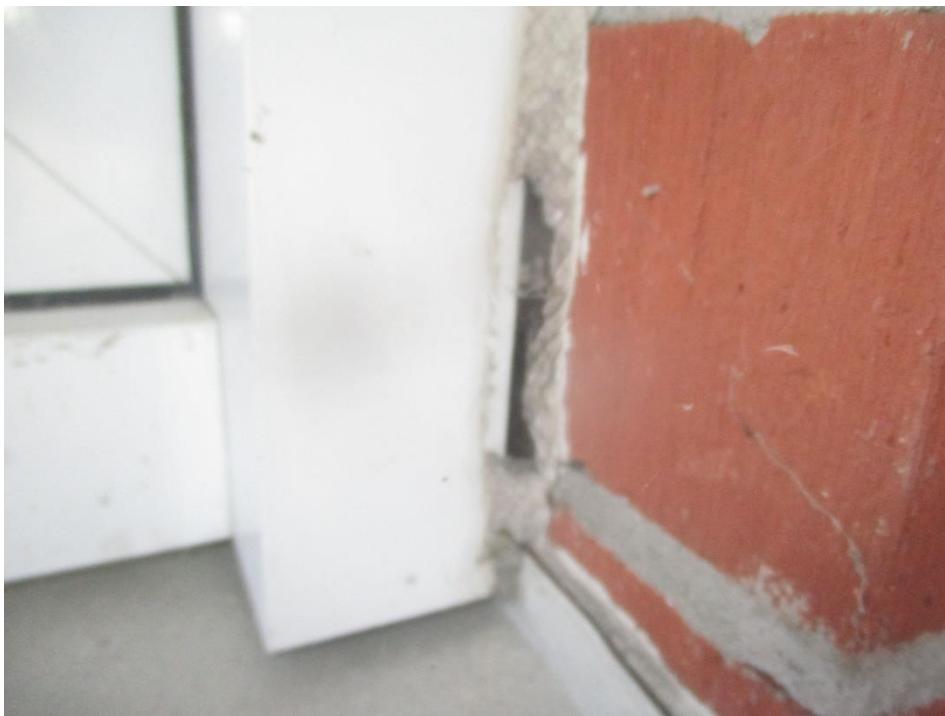
Bild 11: Otäthet mellan fönsterkarm och yttervägg/fasad
