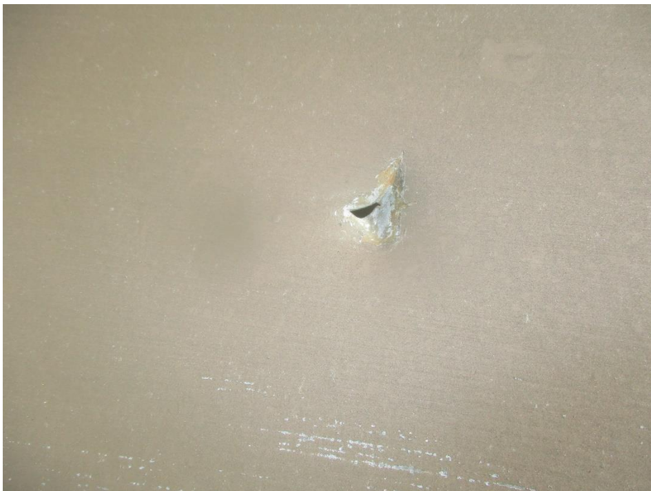
Bild 7: Hål i vattentaksplåten
