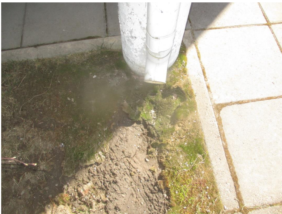
Bild 17: Skadad gräsmatta pga saknad av regnvattenavlopp
