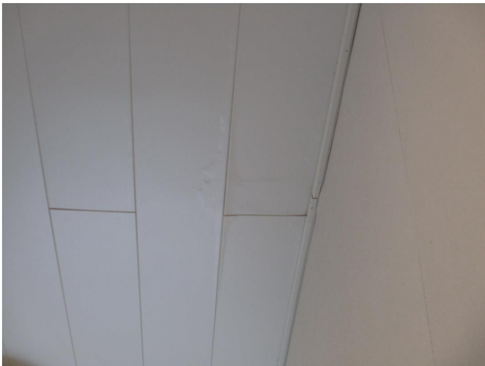
Bild 3: Spår av läckage på innertaket i Skogsvårdsföreningens lokal
