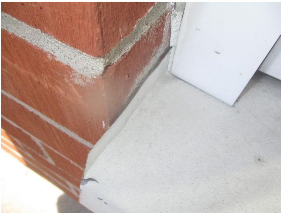
Bild 13: Bristfällig täthet vid fönsterplåts anslutning mot smyg
