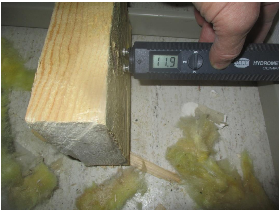
Bild 25: Fuktivtmätning i ytterväggssyll
