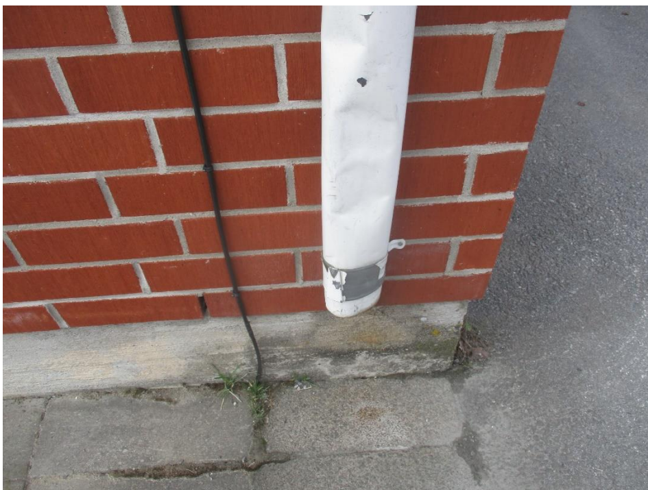
Bild 15: Söndrigt stuprör och skadad sockel
