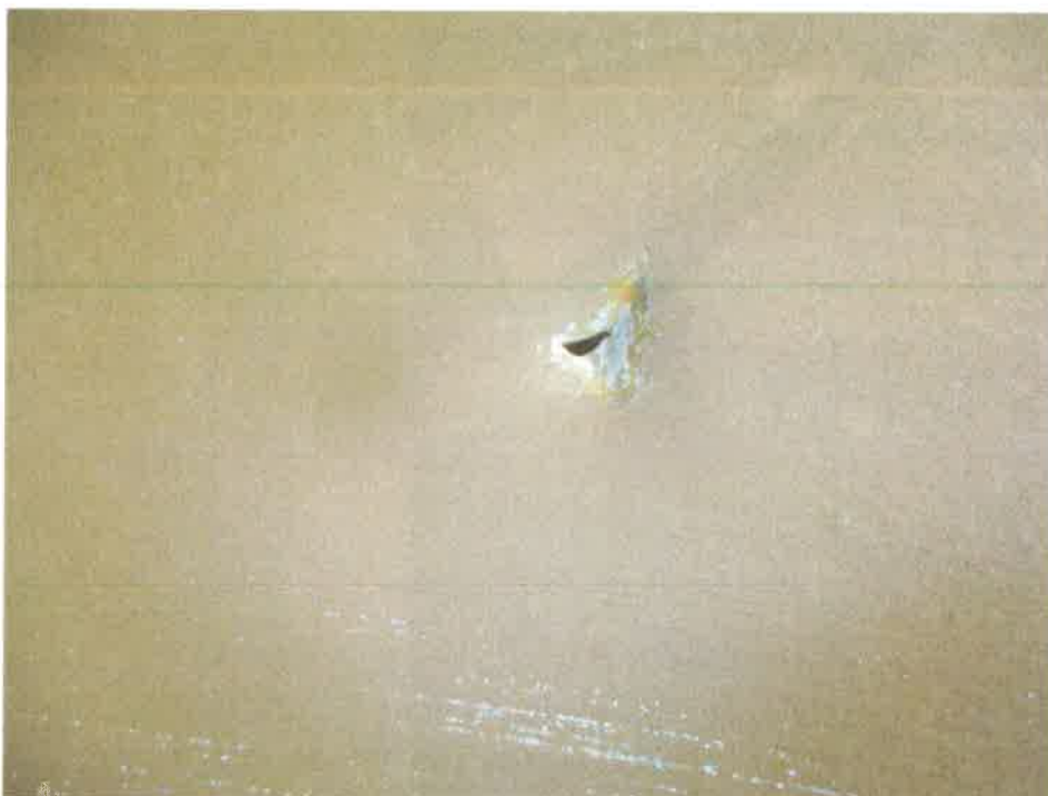
Bild 7: Hål i vattentaksplåten
