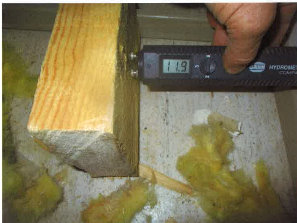
Bild 25: Fuktivtmätning i ytterväggssyll
