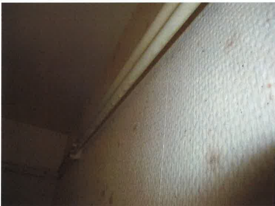
Bild 2: Kondensvatten på bruksvattenröret i lägenhetens badrum
