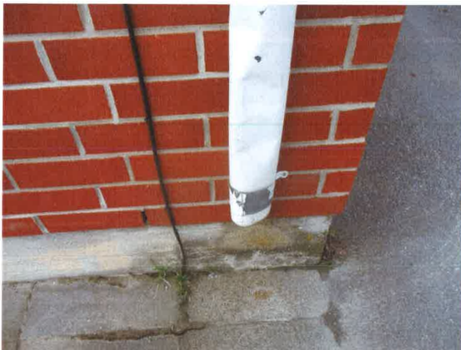
Bild 15: Söndrigt stuprör och skadad sockel
