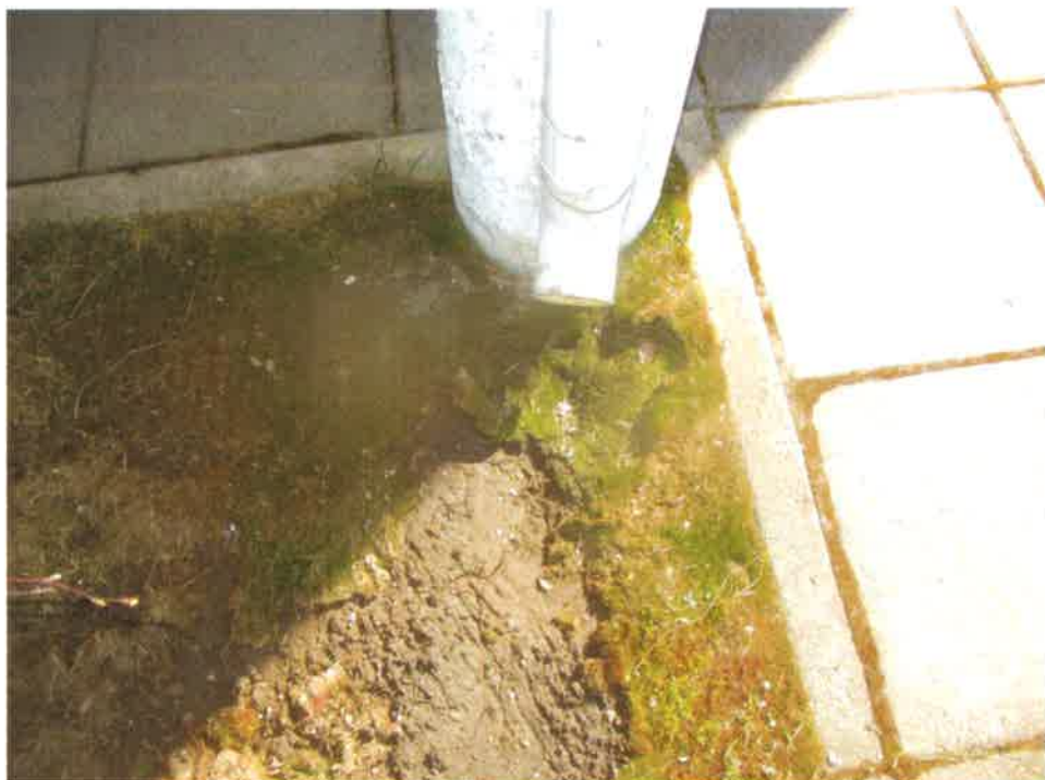
Bild 17: Skadad gräsmatta pga saknad av regnvattenavlopp
