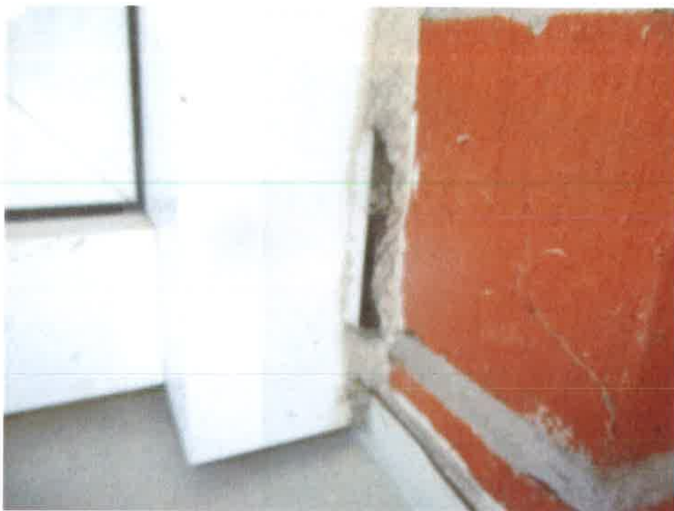
Bild 11: Otäthet mellan fönsterkarm och yttervägg/fasad
