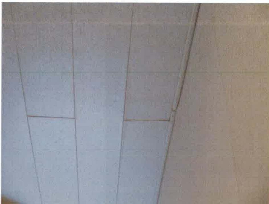
Bild 3: Spår av läckage på innertaket i Skogsvårdsföreningens lokal
