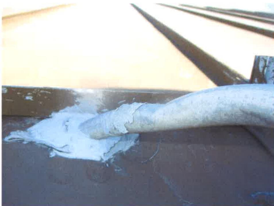
Bild 5: Rör genomföring på vattentak
