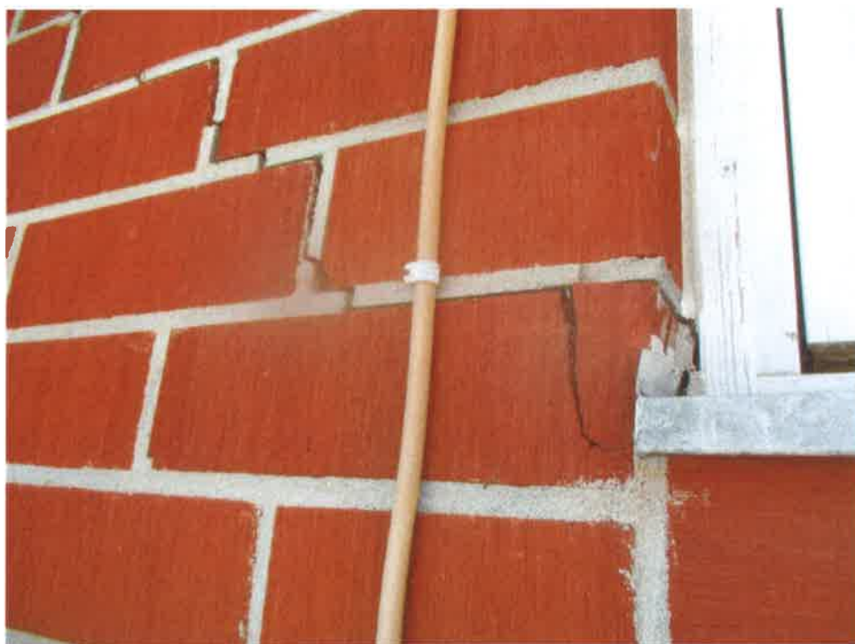
Bild 10: Spricka i tegelfasaden
