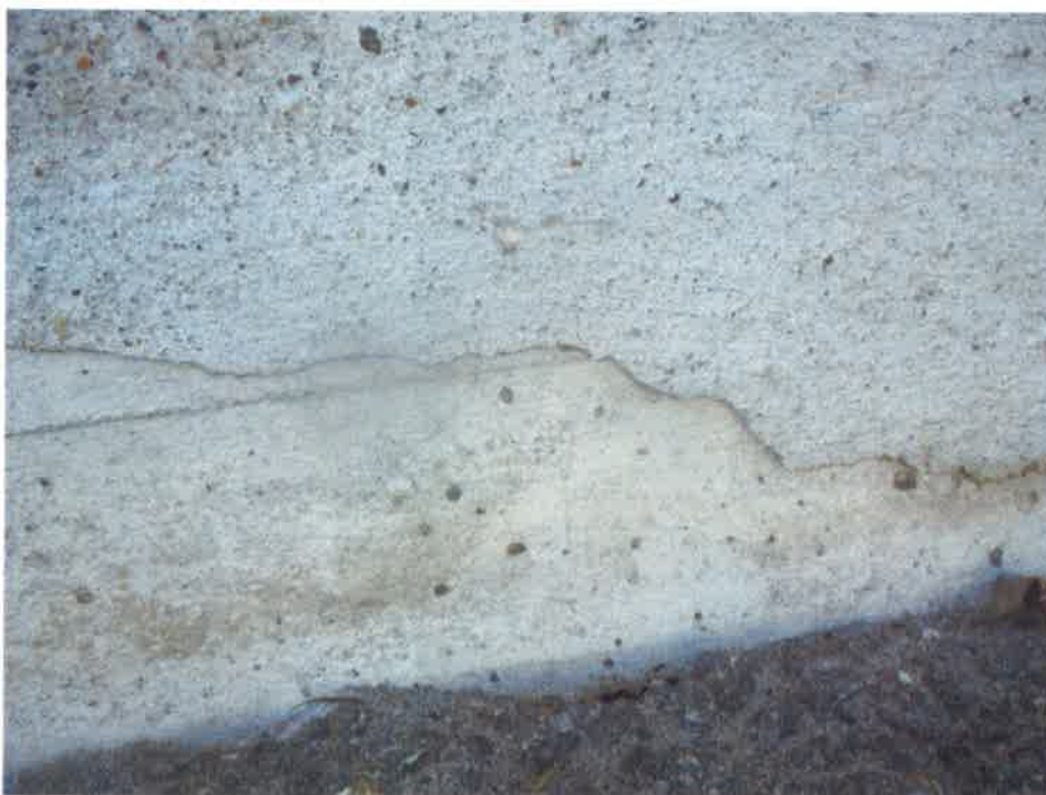
Bild 16: Lossnad rappning från sockel
