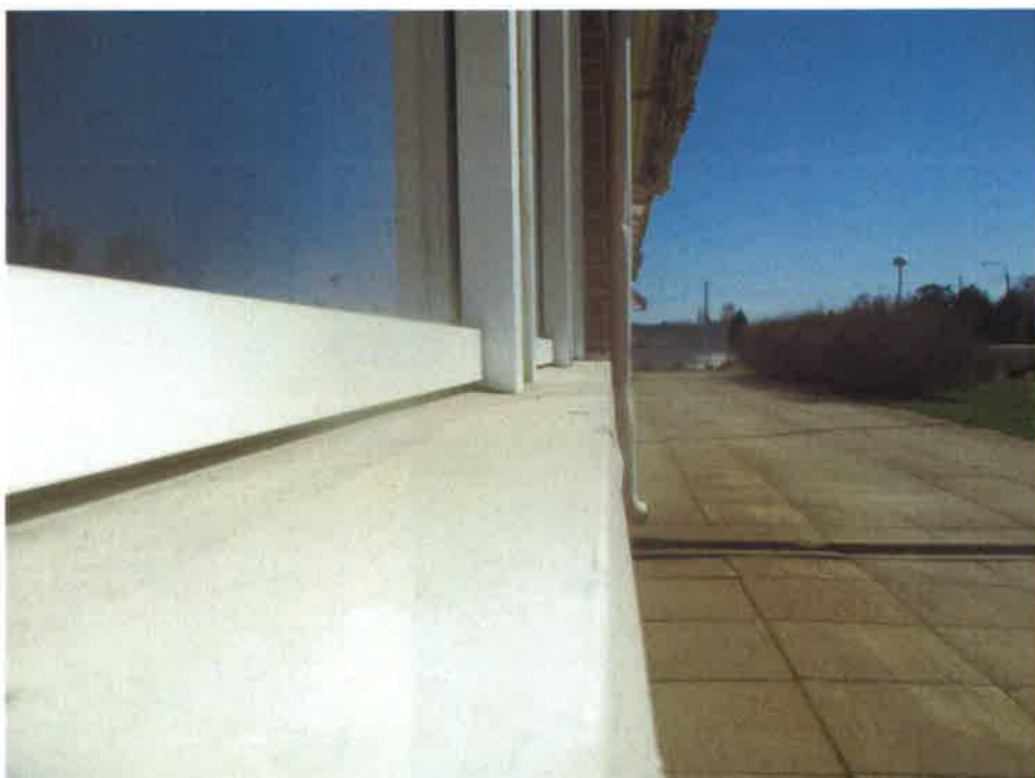
Bild 14: Bristfällig lutning på fönsterplåt
