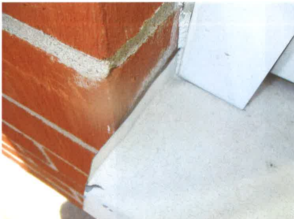
Bild 13: Bristfällig täthet vid fönsterplåts anslutning mot smyg
