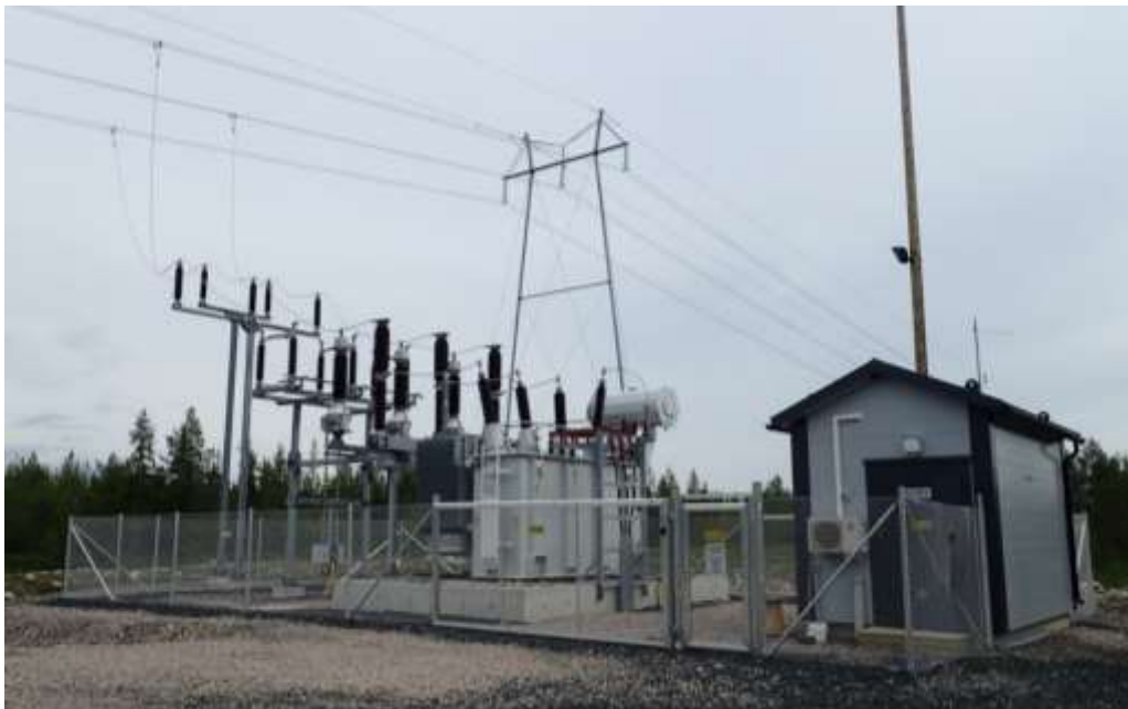
Bild 80. Exempel på en elstation i en vindkraftspark (Minna Takalo, FCG).
