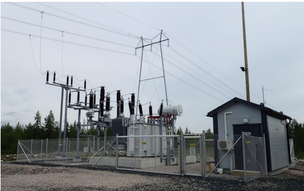
Bild 90. Exempel på en elstation i en vindkraftspark (Minna Takalo, FCG).
