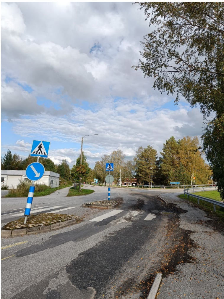
Kuva 5. Päälyste on paikoitellen erittäin huonossa kunnossa ja keskikorokkeet vaikeuttavat raskaan liikenteen kulkua.
