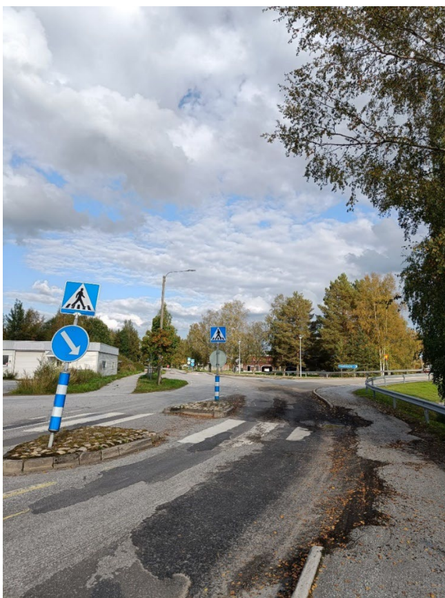
Kuva 7. Päällyste on paikoitellen erittäin huonossa kunnossa ja keskikorokkeet vaikeuttavat raskaan liikenteen kulkua.
